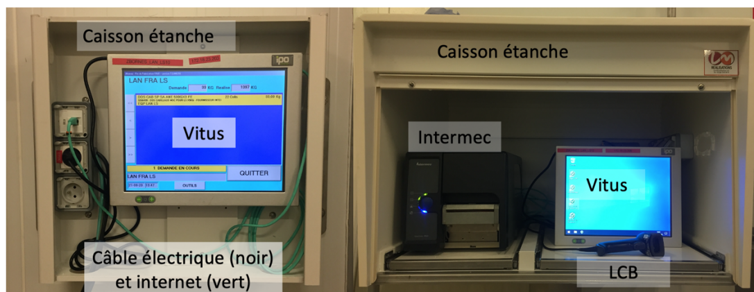
Figure 10 : Photographies du matériel mise en place au LS. Le matériel de la photographie de gauche a été installé en double (source : auteur)
