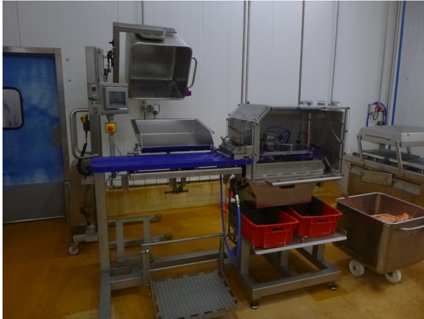
Figure 1: Gratteuse mécanique avec lève-bac dans l'atelier Frais (source auteur)
